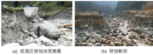
图3 侵蚀作用下的沟道 Fig.3 Channel under erosion
